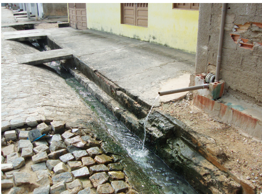
FIGURA 5. Lançamento de esgoto diretamente nas ruas de bairro urbanizado (Foto: Adriano L. Tonetti).
