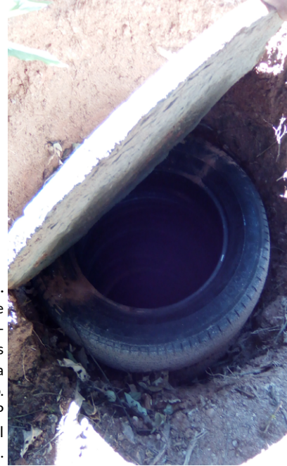
FIGURA 4. Sumidouro de material alternativo: pneus usados e tampa de concreto. Campinas-SP (Foto: Isabel Figueiredo).
