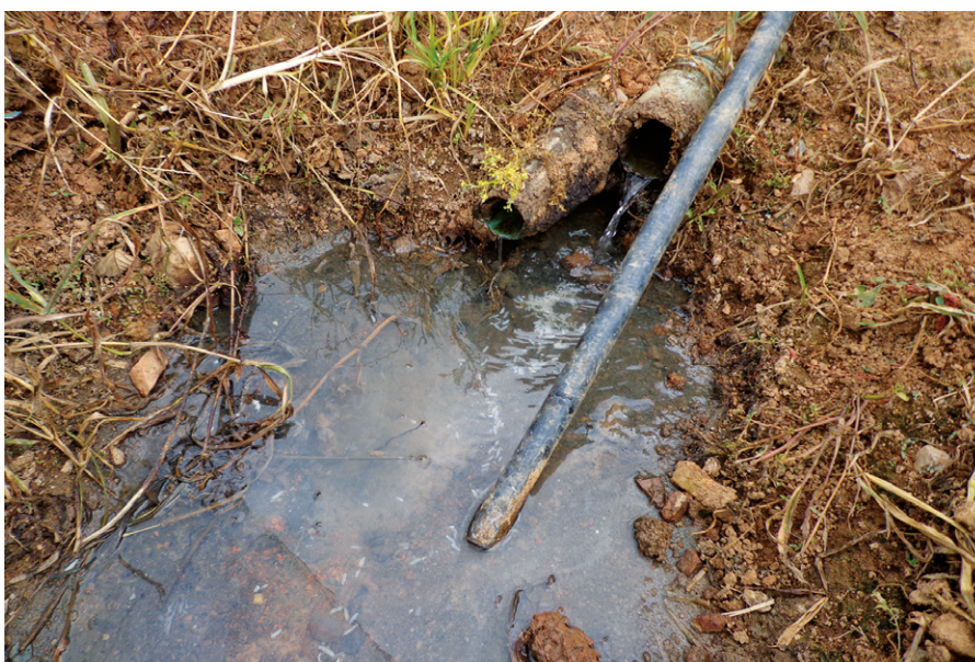
FIGURA 16. Disposição de águas cinzas diretamente no solo (Foto: Isabel Figueiredo).
