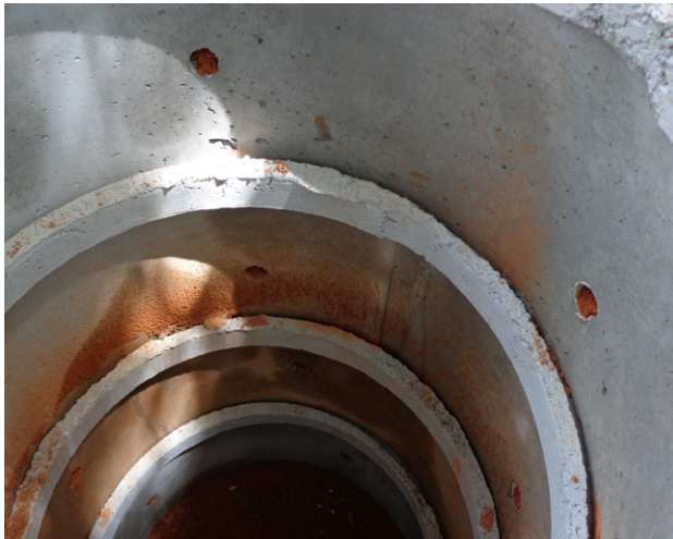
FIGURA 3. Sumidouro de anéis de concreto furados. Campinas-SP (Foto: Isabel Figueiredo).
