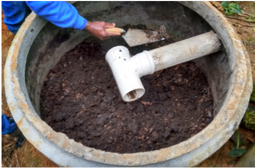
FIGURA 3. Vermifiltro construído com anéis de concreto (zimbras) em São Francisco Xavier-SP. Detalhe do Tê para distribuição do esgoto. Projeto Protegendo as Águas- SFX (Foto: Francisco Madrid).
