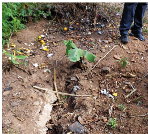
FIGURA 21B. Fossa absorvente com fechamento precário. Tapa de concreto que cedeu com as chuvas (Foto: Isabel Figueiredo).
