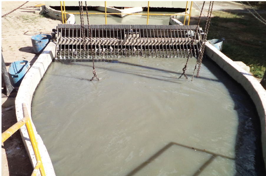
FIGURA 12. Gradeamento em ETE (Foto: Adriano L. Tonetti).
