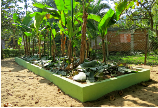
FIGURA 2. Fossa verde ou BET instalada na Praia do Sono, Paraty/RJ. Fonte: otss.org.br/saneamento-ecologico .
