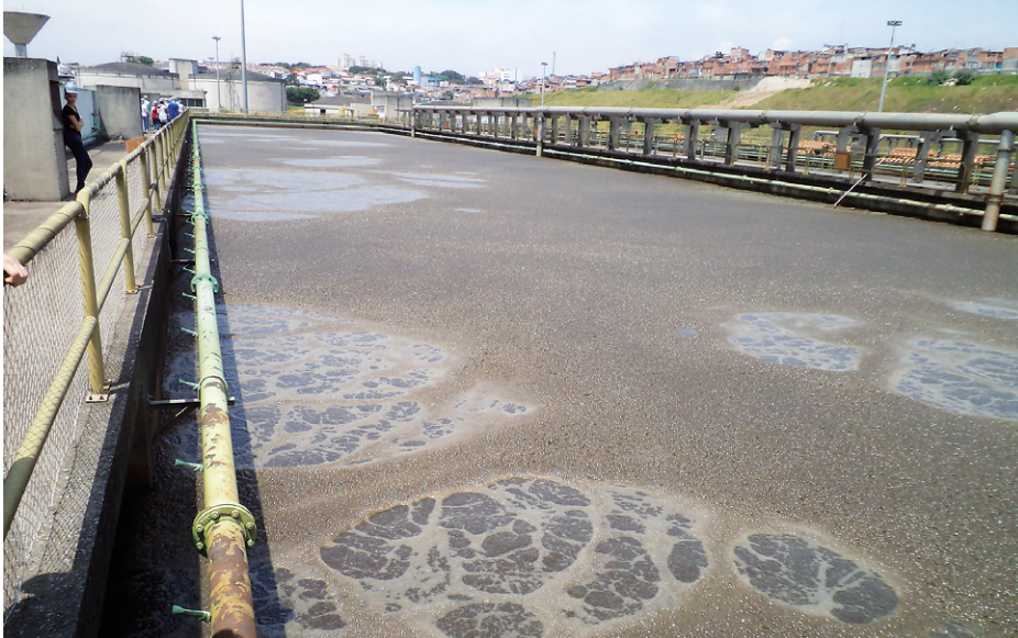
FIGURA 13. Processo de tratamento secundário de esgoto, com tecnologia conhecida como lodos ativados (Foto: Adriano L. Tonetti).
