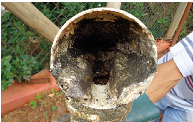
FIGURA 19A. Óleos e gorduras que se acumularam na tubulação de esgoto de 100mm, causando o seu entupimento (Foto: Isabel Figueiredo).
