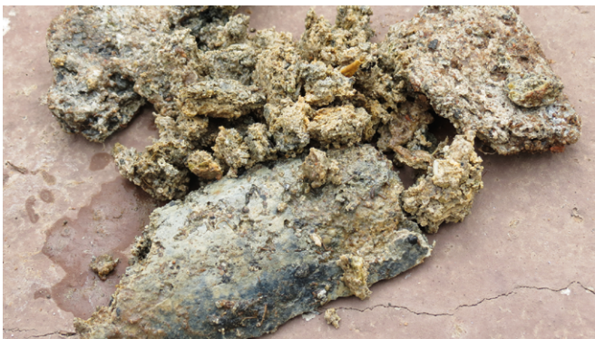
FIGURA 19B. Placas de gordura removidas de tubulação de esgoto residencial (Foto: Luana Cruz).
