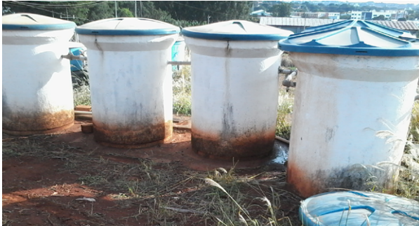
FIGURA 4. RAC instalado na FEAGRI/UNICAMP, Campinas-SP. O RAC é a primeira etapa do tratamento de esgoto de uma parte do campus. Depois do RAC o esgoto segue para SAC (Foto: Isabel Figueiredo).
