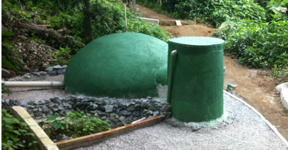
FIGURA 2. Biodigestor de alvenaria, integrante de um BSI (T15) para tratamento de esgoto do Vale Encantado- RJ. (Projeto: Otávio Barros e Valmir Fachini. Foto: Leonardo Adler).
