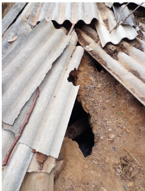
FIGURA 21A. Fossa absorvente com fechamento precário. Tapa de telha de fibrocimento (Foto: Isabel Figueiredo).
