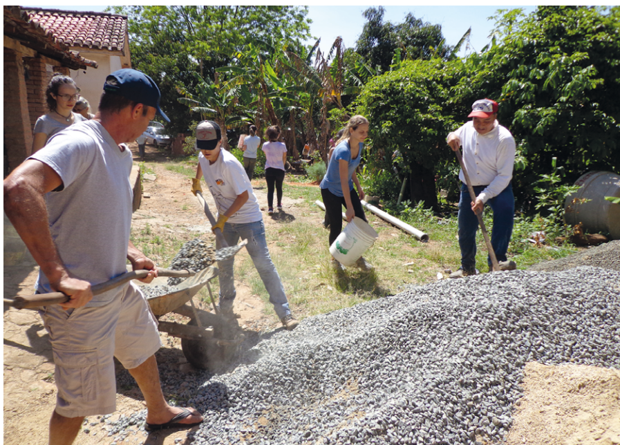
FIGURA 9A. Imagens de mutirões para a construção de sistemas de tratamento de esgoto no Projeto Saneamento Rural/Unicamp. Mutirão de construção de uma bacia de fossa verde ou evapotranspiração (Foto: Bárbara Silva).
