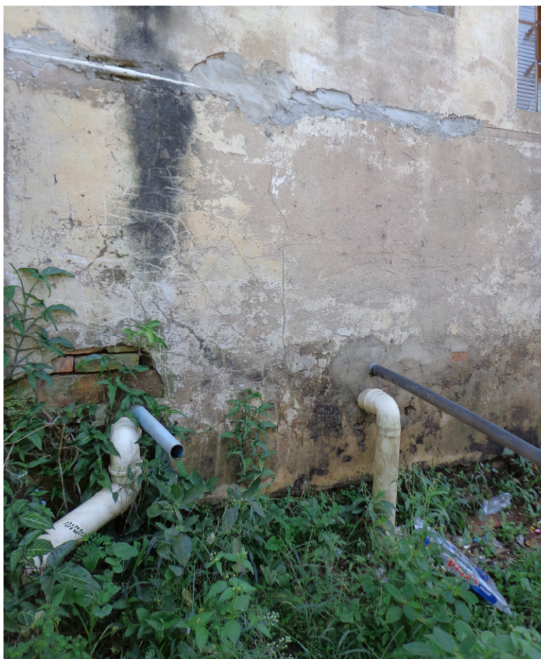
FIGURA 15. Encanamento na parte externa do domicílio mostrando a segregação do esgoto em pelo menos duas frações distintas: águas cinzas (mangueiras flexíveis pretas e tubos azuis) e águas de vaso sanitário (tubulação branca de PVC) (Foto: Isabel Figueiredo).
