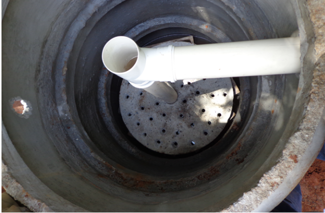
FIGURA 2. Filtro anaeróbio em construção. Detalhe do fundo falso apoiado em blocos de concreto. A imagem também mostra a tubulação de PVC 100mm por onde o esgoto entra no fundo do filtro (Foto: Adriano Tonetti).
