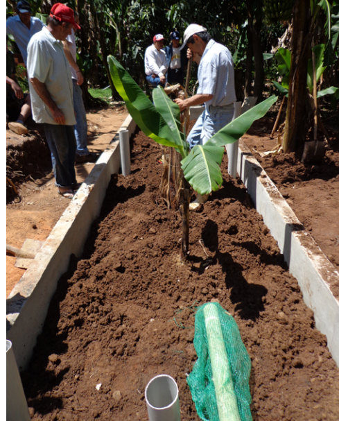
FIGURA 4. Preenchimento da camada de terra e plantio das bananeiras. Abaixo é possível ver o “ladrão” de tubo PVC perfurado e envolto por tela de mosquito (Foto: Luana Cruz).
