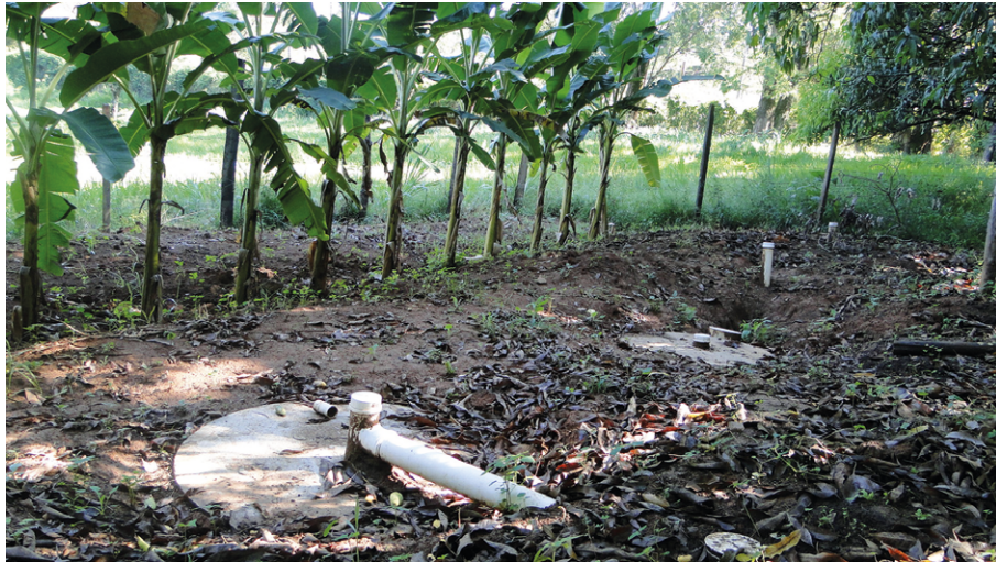
FIGURA 1. Exemplo de solução unifamiliar para tratamento de esgoto em comunidades isoladas. Tanque séptico seguido de filtro anaeróbio e vala de infiltração em comunidade rural de Campinas-SP (Foto: Isabel Figueiredo)
