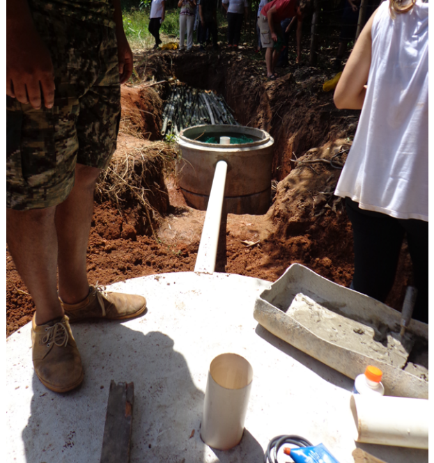
FIGURA 4. Filtro anaeróbio em construção. No primeiro plano, um tanque séptico. Depois o filtro anaeróbio e no fundo uma vala de infiltração preenchida com bambu (Foto: Isabel Figueiredo).
