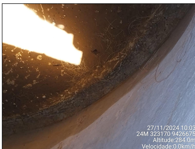
Figura 20 - Infiltração de raízes na cisterna
