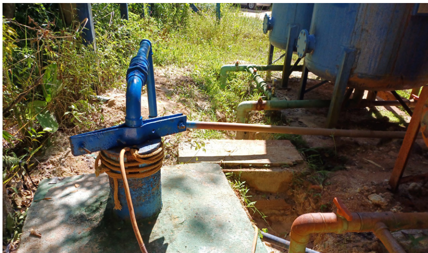
Figura 4. Poço tubular profundo que abastece a comunidade de Santo André (ETA).
