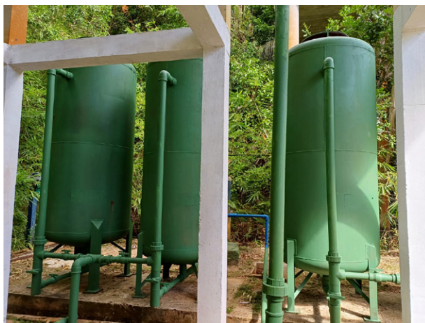
Figura 10. ► Vista dos filtros pressurizados da ETA (estão fora de operação).
