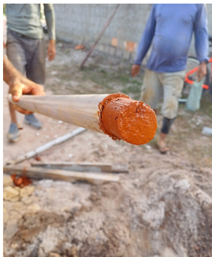
Figura 14. Tubulação totalmente interrompida pelo acúmulo de ferro.
