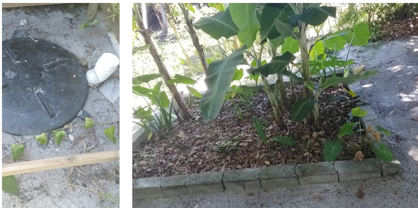
Figura 18. Biodigestor comercial e Bacia de Evapotranspiração - BET presentes em casas visitadas durante o cadastro.
