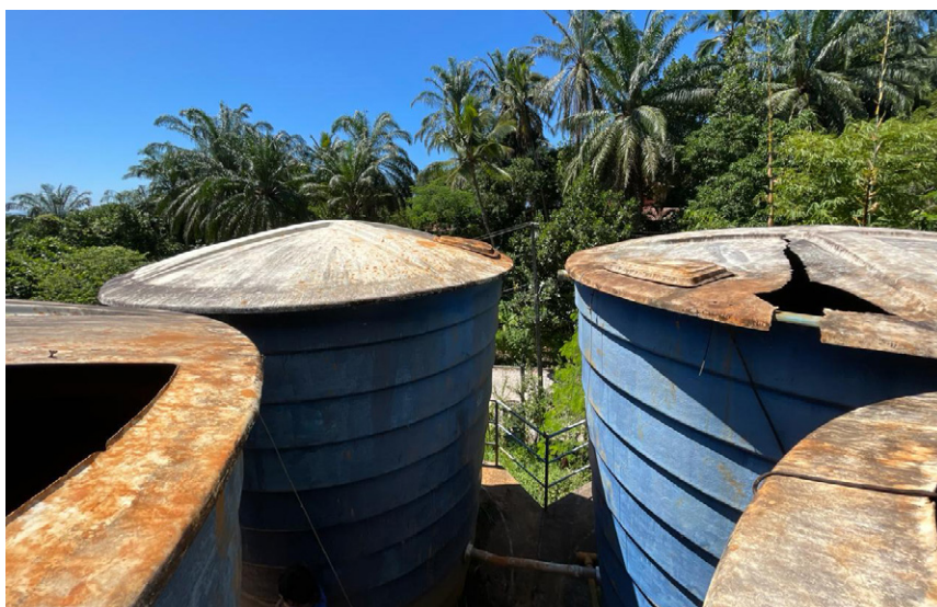
Figura 9. Vista geral dos reservatórios da ETA.
